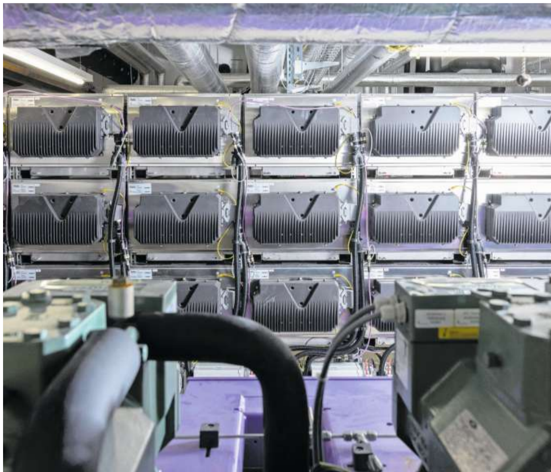
Die 7 Tonnen schwere Ökobatterie liefert der Migros-Filiale genug Energie in der Nacht. Bild: Severin Bigler
